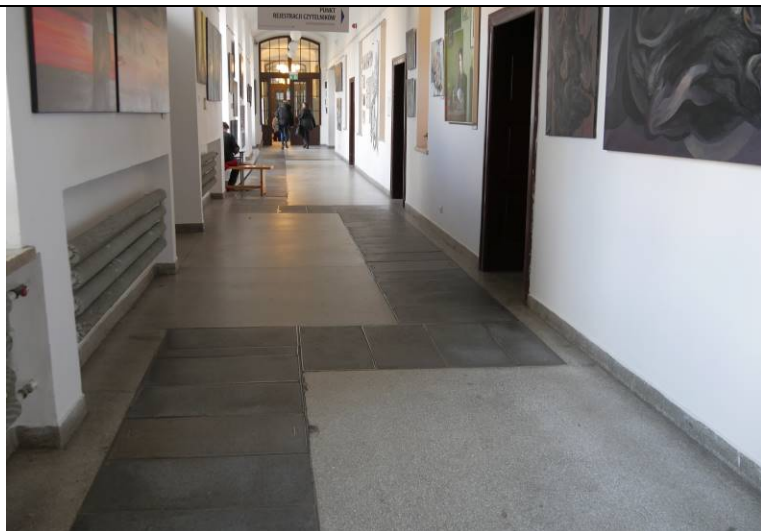
Kanał c.o. w komunikacji z posadzką lastriko – lewa strona
