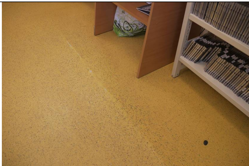
Widoczny zarys kanału pod wykładziną PCV
