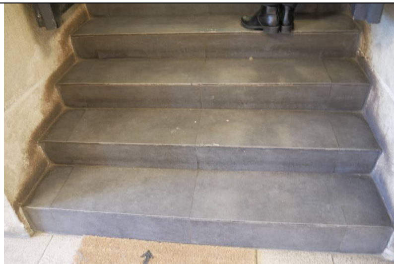
Schody w holu głównym (posadzka ceram., brak cokołów)
