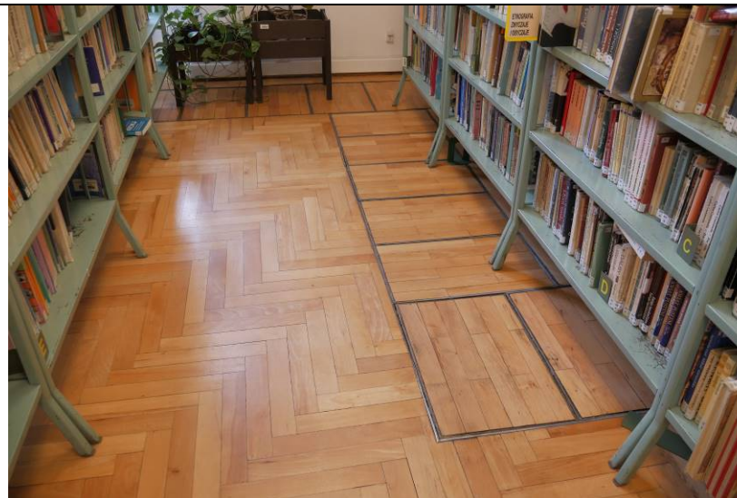
Kanał instalacyjny c.o. w pomieszczeniu z parkietem
