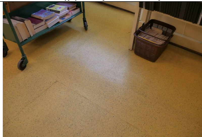
Widoczny zarys kanału pod wykładziną PCV
