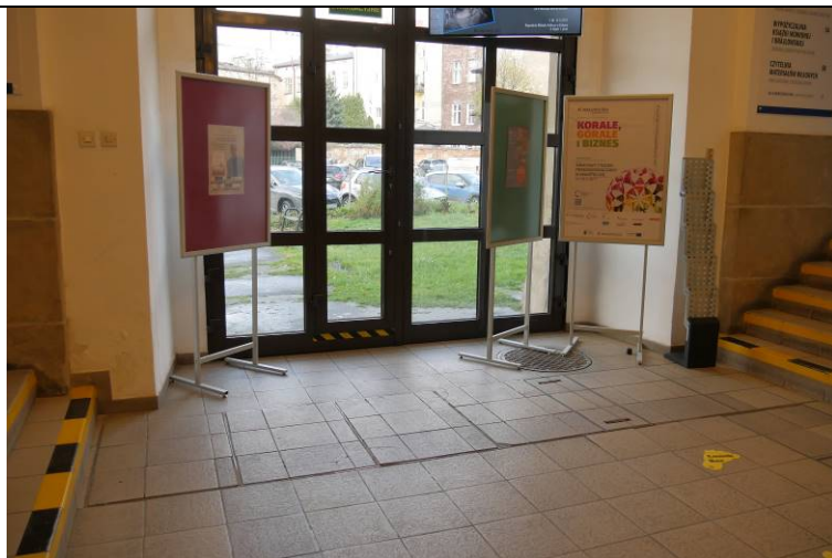
Kanał c.o. w holu głównym (posadzka ceramiczna)
